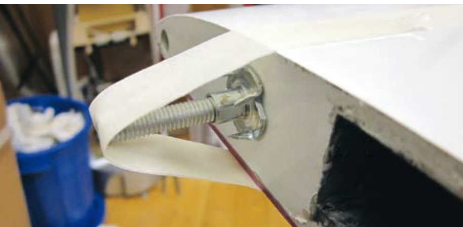
Bis zum Aushärten des Klebers ist die Gewindestange mit der aufgeschraubten Kronenmutter mit Tape gesichert. Anschließend wird der Flügel senkrecht gestellt und das Harz eingebracht
